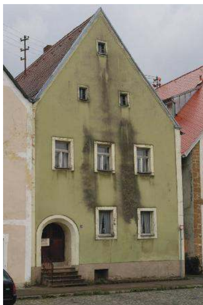
Beispiel einer sanierungsbedürftigen Frontfassade im Bereich Marktplatz
